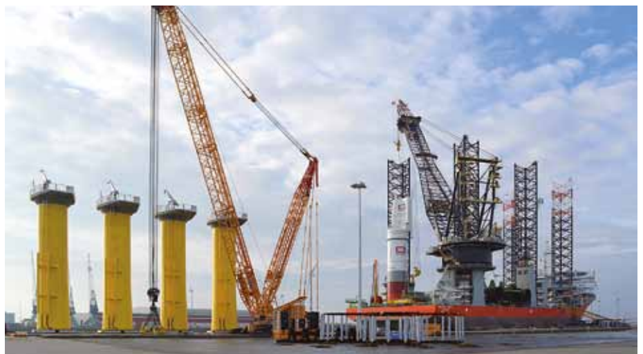
Richtig dicke Dinger: Auf diesen Fundamenten werden die Windkraftanlagen des Offshore-Parks „Borkum Riffgrund 1“ in der Nordsee stehen.
